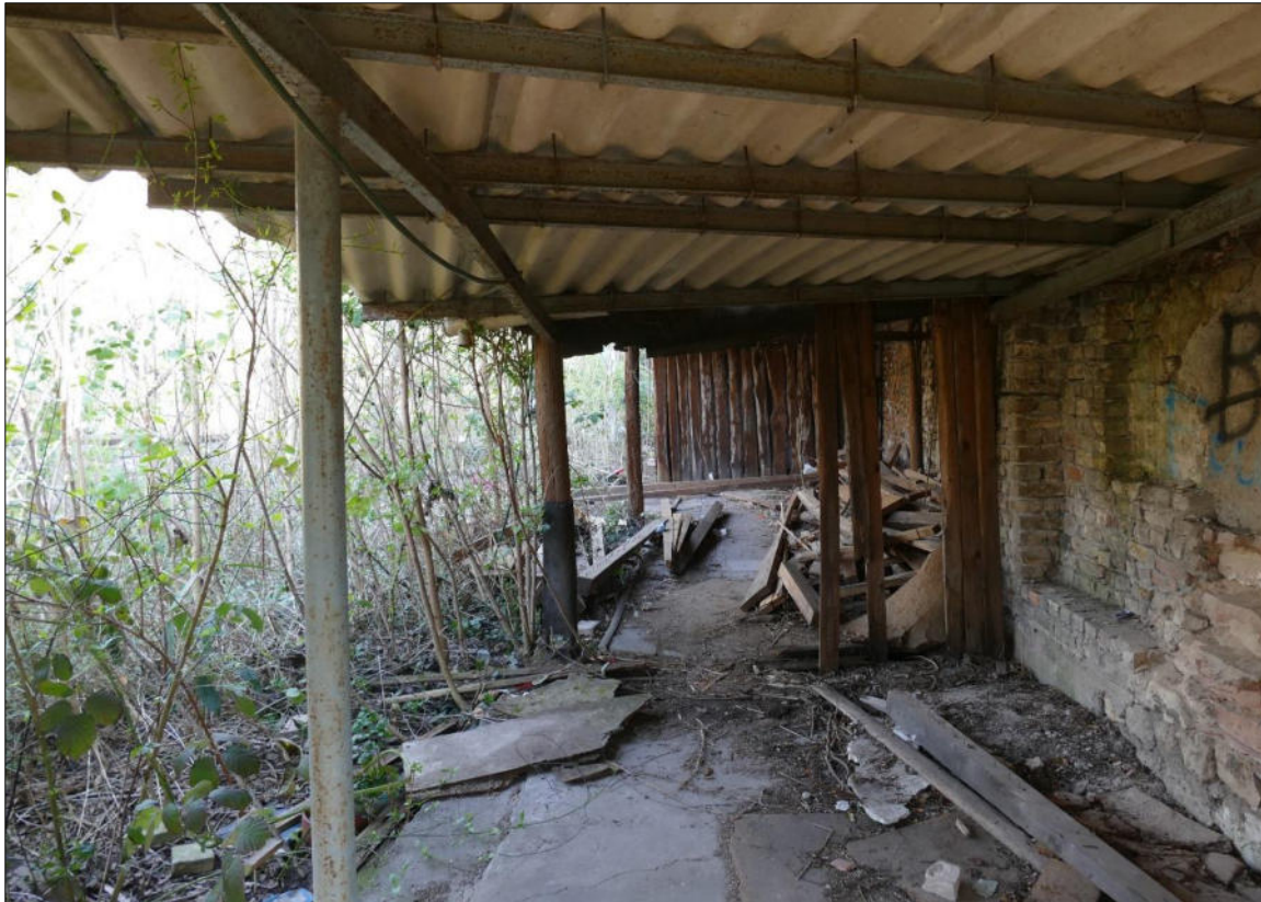
Abbildung 15 Im Bereich der Gartenfläche befinden sich zahlreiche Hütten und Verschläge mit Backsteinmauern (Foto: IBU, 04/2025).
