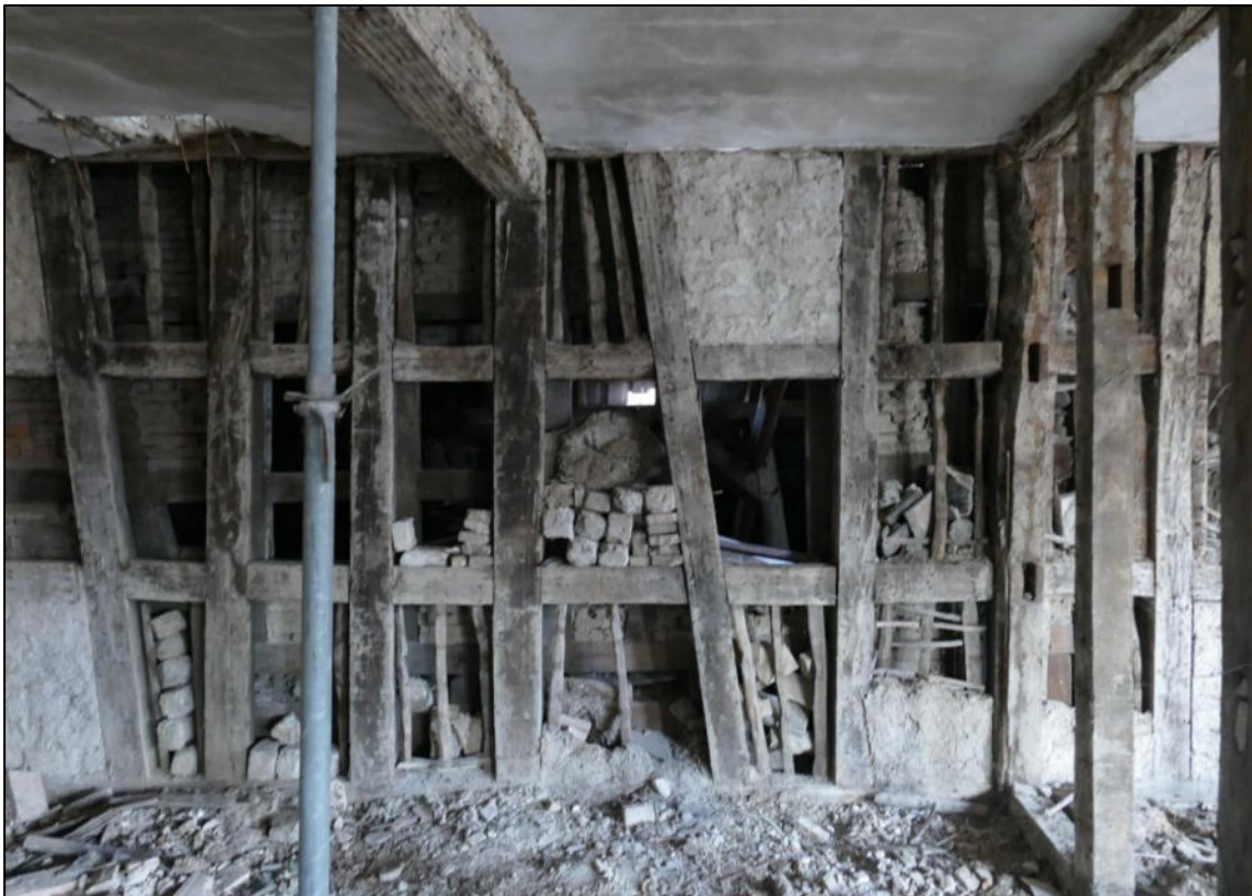
Abbildung 16 Offener Zugang zu den Zwischenräumen von Haus 1 und dem danebenliegenden Gebäude. Dieser Bereich weist zahlreiche Hohlräume auf (Foto: IBU, 04/2025).
