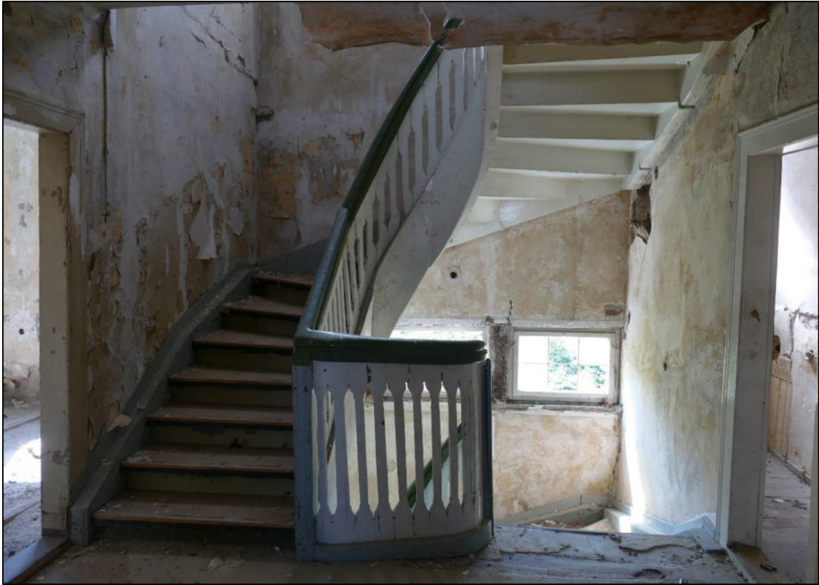
Abbildung 19: Innenbereich von Haus 2. In weiten Teilen ist der Putz noch vorhanden, dennoch befinden sich zahlreiche Risse in den Wänden (Foto: IBU, 04/2025).
