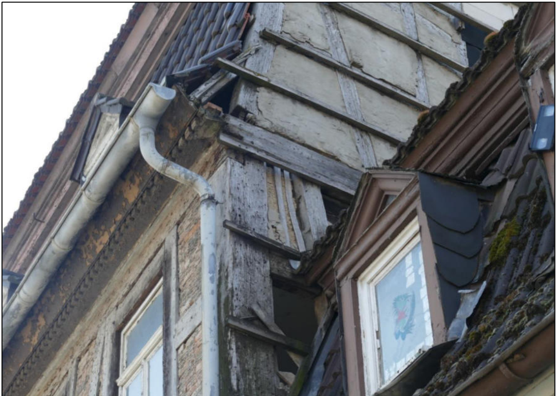
Abbildung 14 Die Fachwerkgebäude sind durch zahlreiche Spalten in der Fassade und im Dach sowie durch geöffnete Fenster für Tiere zugänglich (links Haus 1, rechts Zwischengebäude). (Foto: IBU, 04/2025).
