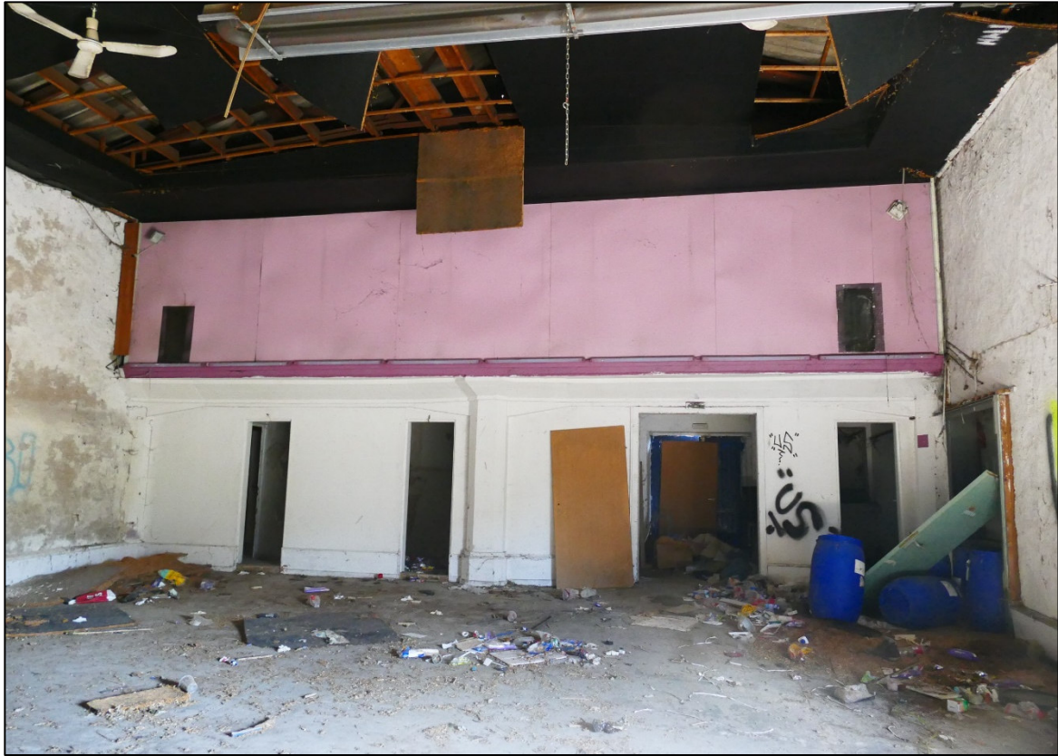
Abbildung 11: Für einen Abriss vorgesehene ehemalige Kinohalle mit offener Zwischendecke und Spuren von Vandalismus (Foto: IBU, 04/2025).
