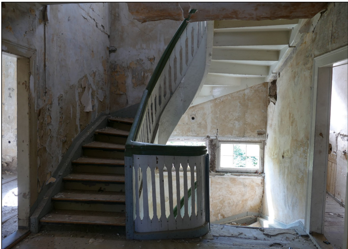
Abbildung 10: Innenbereich von Haus 2. In weiten Teilen ist der Putz noch vorhanden, dennoch befinden sich zahlreiche Risse in den Wänden (Foto: IBU, 04/2025).
