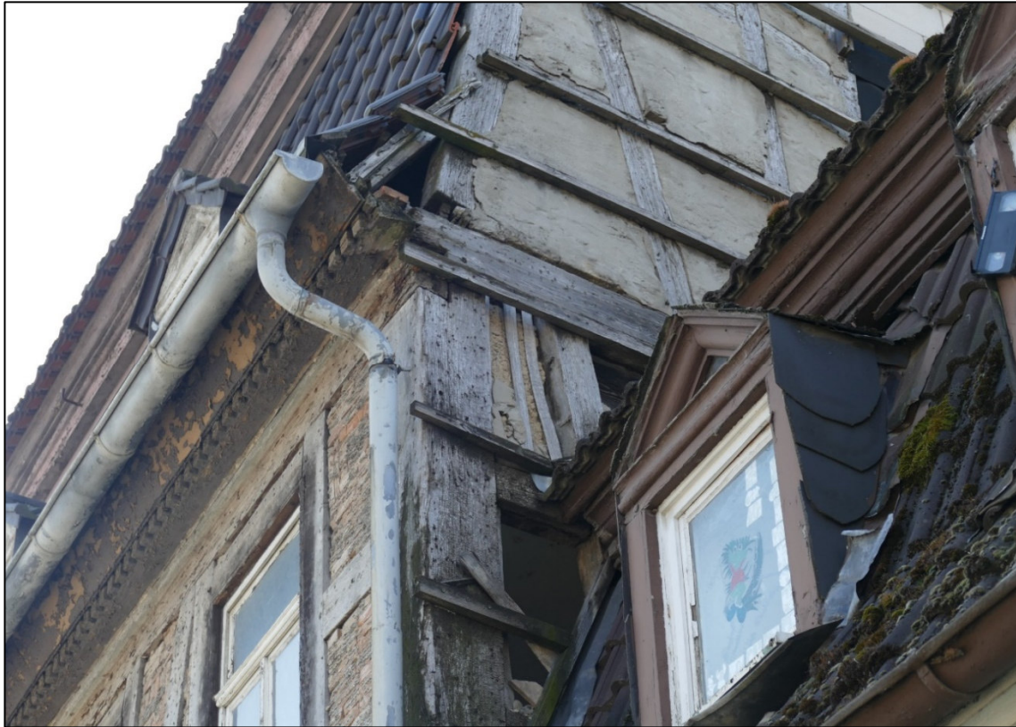
Abbildung 5: Die Fachwerkgebäude sind durch zahlreiche Spalten in der Fassade und im Dach sowie durch geöffnete Fenster für Tiere zugänglich (links Haus 1, rechts Zwischengebäude) (Foto: IBU, 04/2025).
