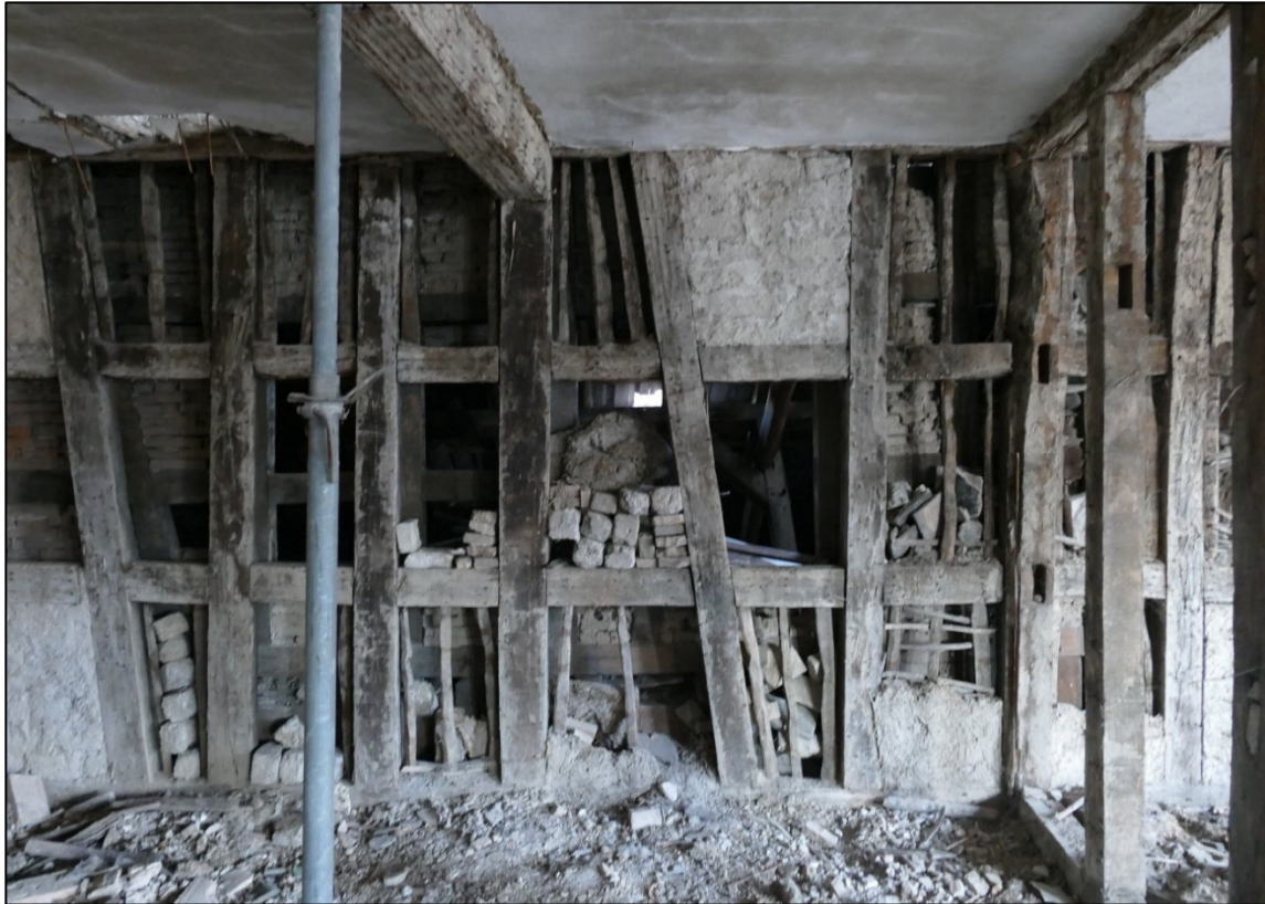
Abbildung 7: Offener Zugang zu den Zwischenräumen von Haus 1 und dem danebenliegenden Gebäude. Dieser Bereich weist zahlreiche Hohlräume auf (Foto: IBU, 04/2025).
